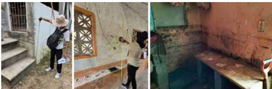
Figura 4. Inscripciones de altura alcanzada por el flujo en muros interiores y exteriores de viviendas. Las marcas visibles y su medición con cinta métrica traducen la intensificación del arroyo en escala cuantificable, convirtiendo la fuerza del agua en registro material.
